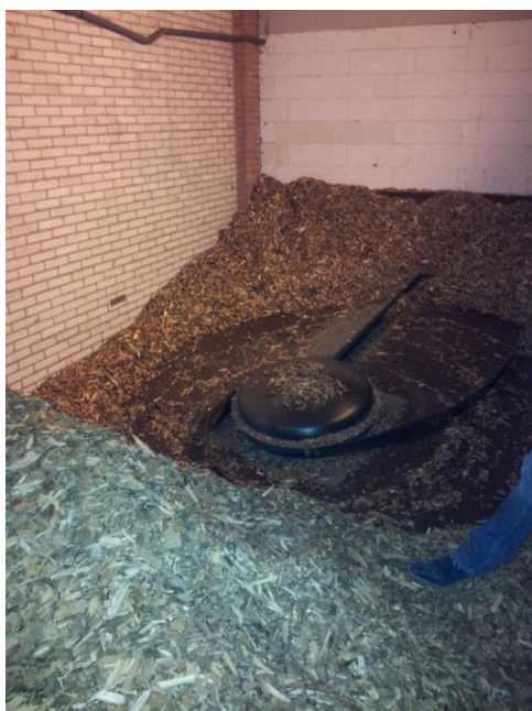
Chipbunker met transportveren (vegen de snippers naar de ketel)
